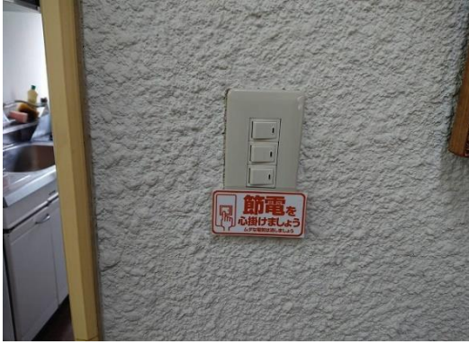
電気① 未使用時の消灯の呼びかけ
