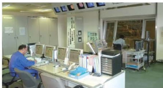
施設の運転管理
