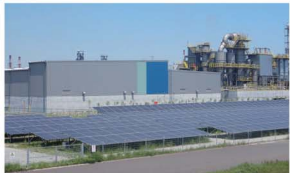
みずしま資源再生センターに隣接した太陽光発電設備
