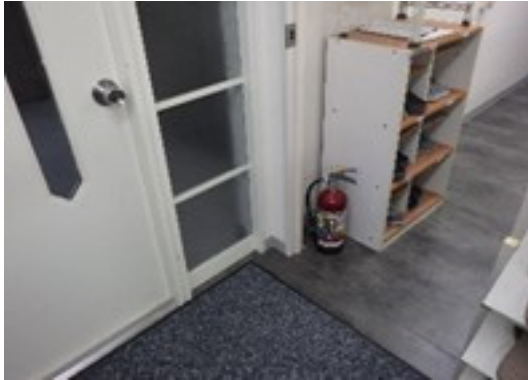
消火器設置場所【事務所】
