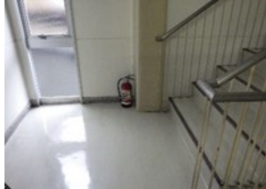
消火器設置場所【建屋2階】
