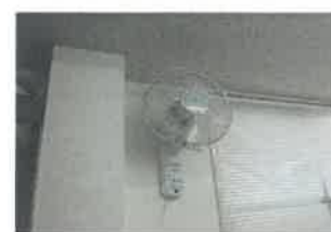
サーキュレーター
