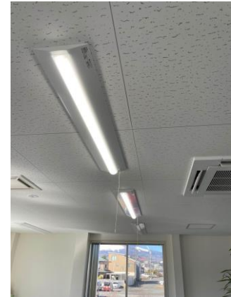
事務所内照明のLED化
