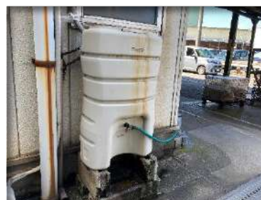
雨水タンク（第二工場）
