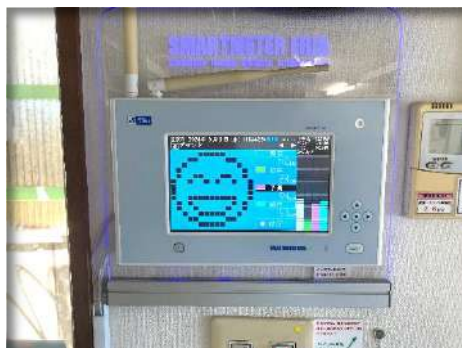
スマートメーター
