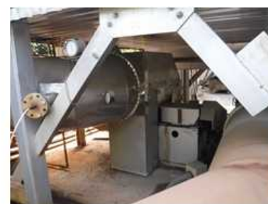
排ガス誘引ファン
