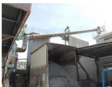
バグフィルターと急冷塔
