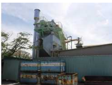
排ガス設備の電気集塵機
