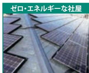
ゼロ・エネルギーな社屋 屋根に太陽光パネル (82 枚分) の設置
