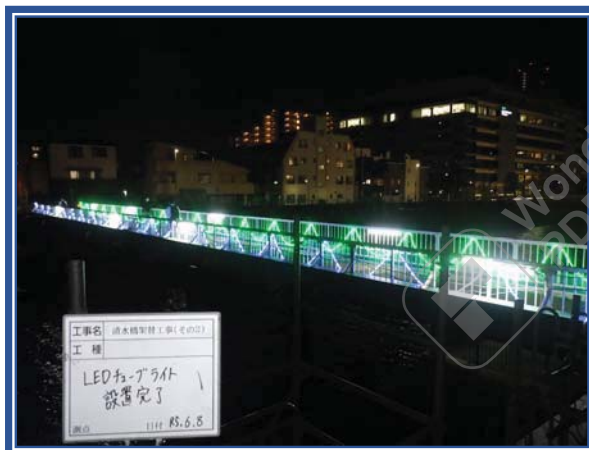
チューブライト設置状況
