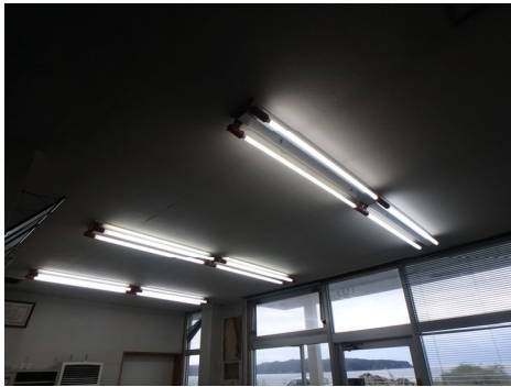
LED照明設備 移行
