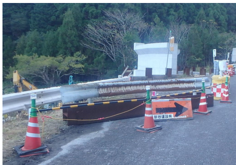
新技術導入:ソーラー電源 (夜間灯火設備)
