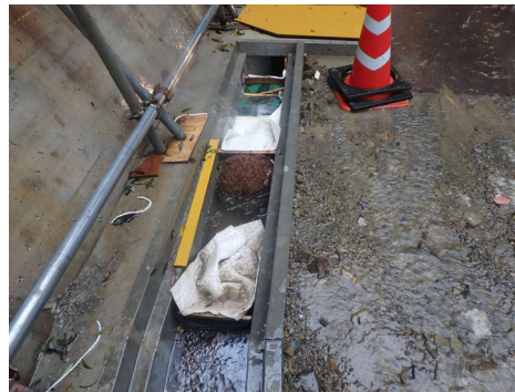
濁水流出対策(透過型濁水処理沈殿池設置)
