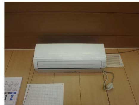
環境対応型エアコン設備 移行
