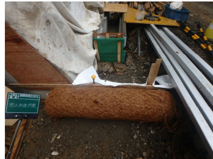
濁水流出対策(透過型濁水処理沈殿池設置)
