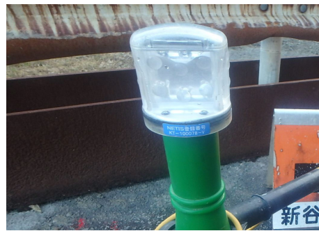
新技術導入:ソーラー電源 (夜間灯火設備)
