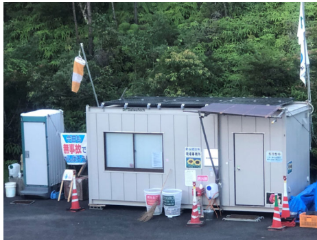
太陽光発電システムの利用 (現場事務所・休憩所)
