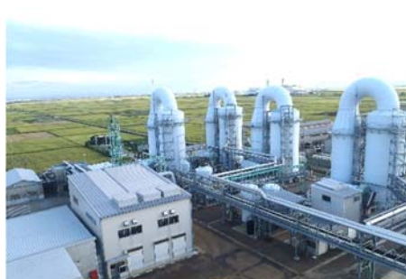
【ヨウ素製造設備】
