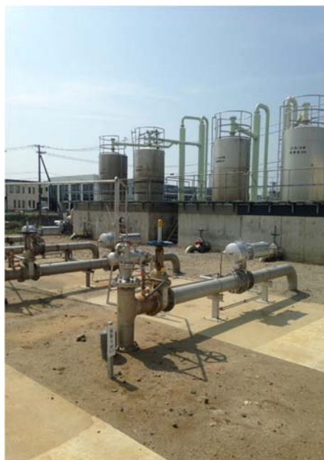
【天然ガス採取設備】
