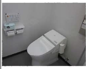
環境配慮型節水トイレ
