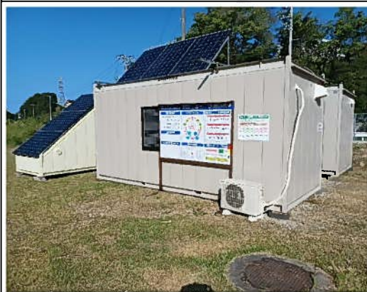
ソーラーパネル設置状況
