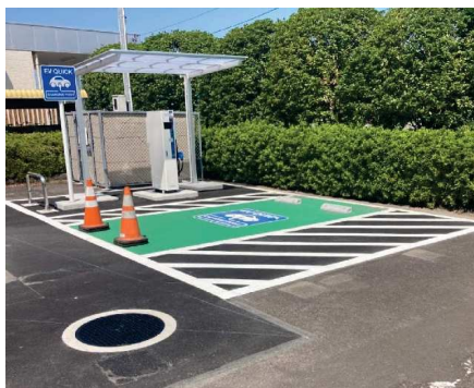
電気自動車用急速充電装置設置
