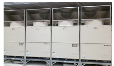
新たに設置されたみやこ斎苑空調用室外機
