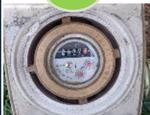
水道メーター
