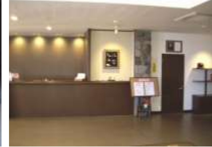
ロビーLED照明器具導入
