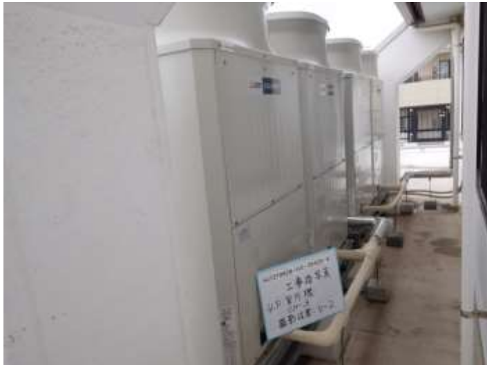
4階フロア屋外 室外機置場
