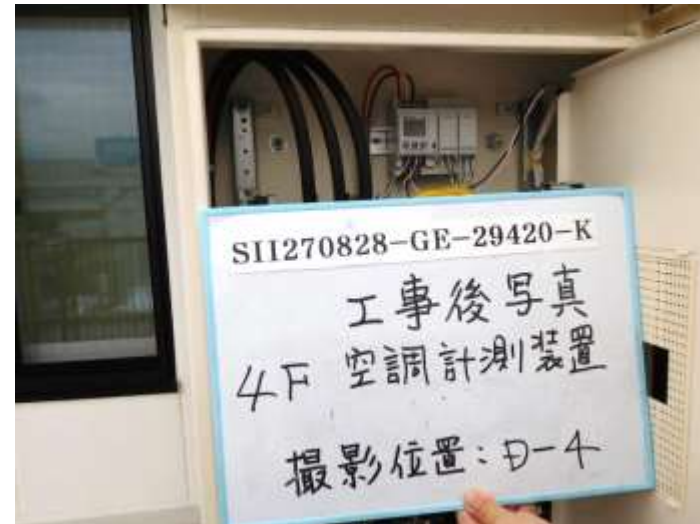
4階フロア 空調機計測装置
