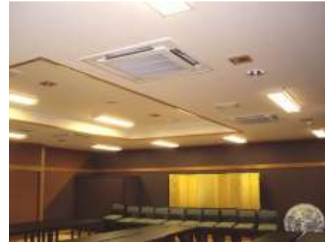
宴会場 高効率空調・LED照明器具 導入
