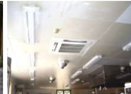
厨房高効率空調・LED照明器具導入
