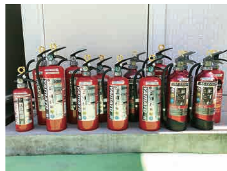
消火器の点検を実施
