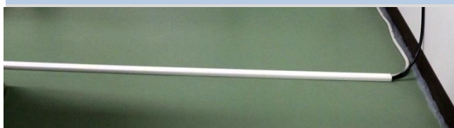
電気配線カバーの段差
