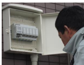
デマンドモニター内部
