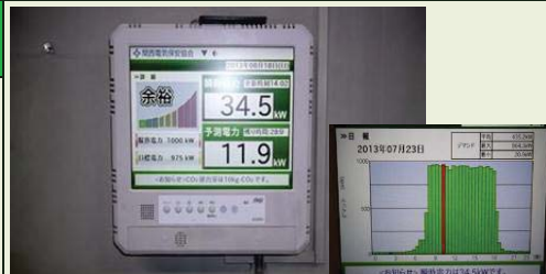
デマンド監視システムの導入
