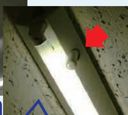
廊下・トイレ照明へ の人感センサー設置。
