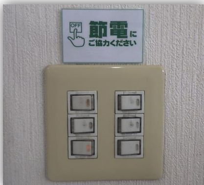
◇電気消費量抑制 節電ステッカーの表示
