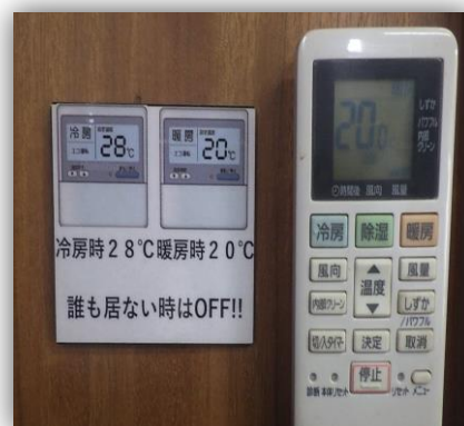
◇電気消費量抑制 エアコン節電ステッカーの表示
