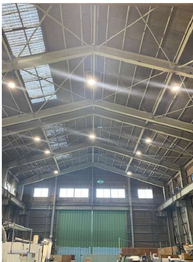
工場内電気設備オールLED化
