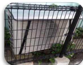
室外機の高温防止・点検
