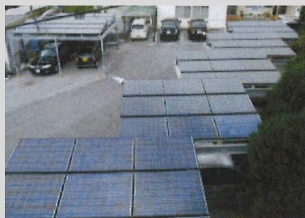
太陽光発電設備(9.2kW)
