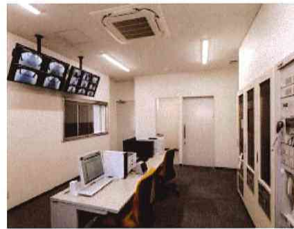
24時間365日稼働の防災センター
