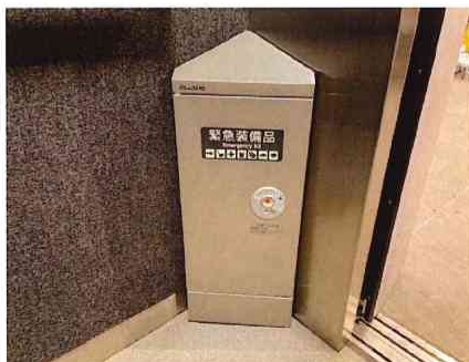
防災キャビネットの設置
