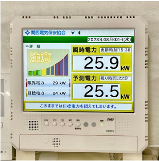
デマンド監視装置
