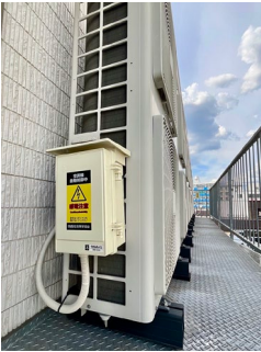
空調機自動制御
