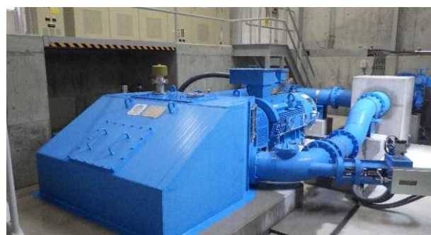
奥伊吹第二発電所 水力発電機
