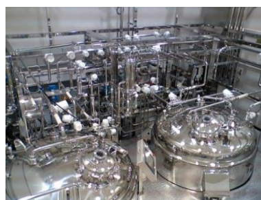
精製水供給ライン
