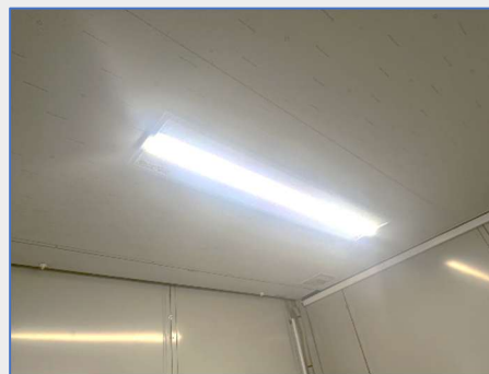
LED 照明 (処分場)
