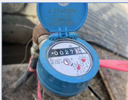
設置した水道メーター
