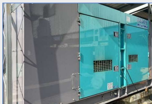
新規導入した発電機
