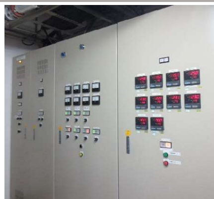
5 工場 空気調和設備表示盤
