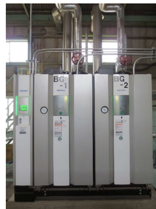
小型ボイラー 1号機、2号機
