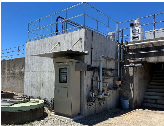
廃水処理場 液中膜の様子
