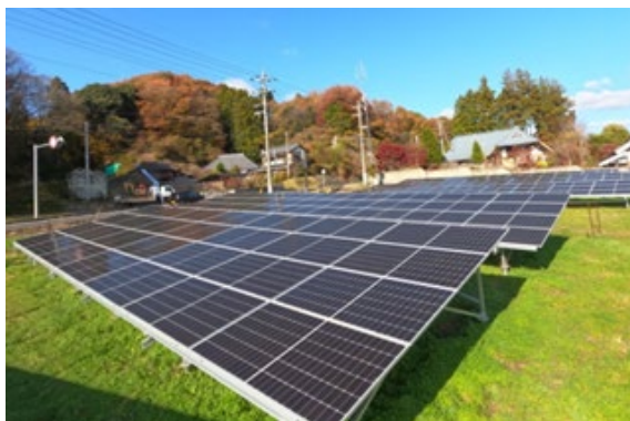
オフサイトコーポレートPPAの導入
