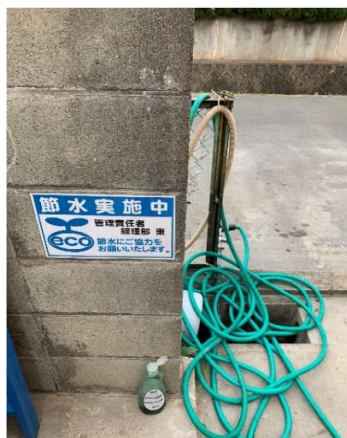
営業所工場内水道
