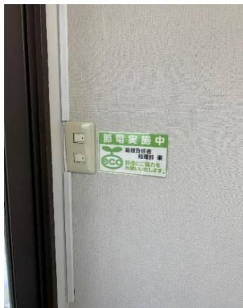
営業所事務所内電気
