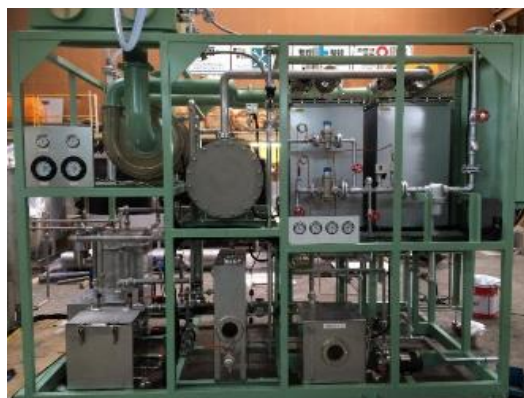
溶剤回収装置
