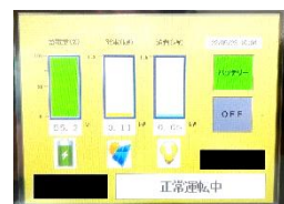
プレハブ内の電力モニター
