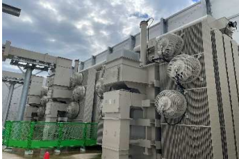
③キオクシア四日市工場 特高受変電設備工事
