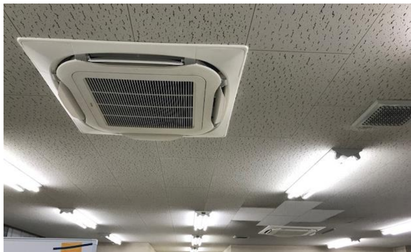
省エネタイプエアコンに入替え・LED照明
