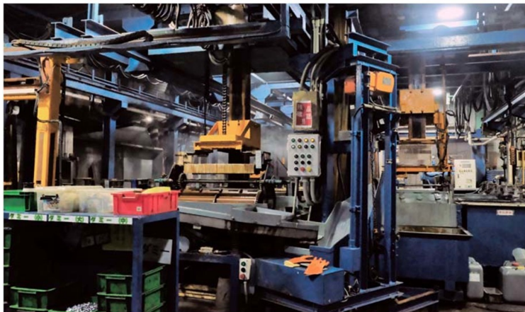
ねじやボルトの亜鉛めっき加工を行う設備
