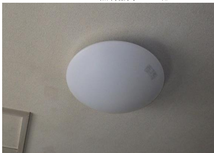
照明器具のLED化
