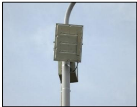
バッテリー電源⇒LED 街路灯(タイマー設定)
