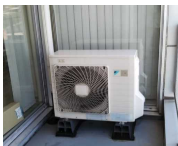
エアコン室外機清掃点検 8月
