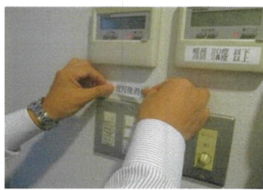
空調管理 (冷房25℃、暖房20℃に再設定)
