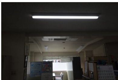
不使用照明の消灯
