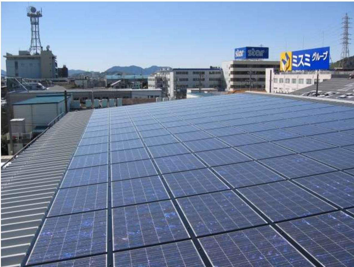
半左エ門工場屋根設置ソーラーパネル
