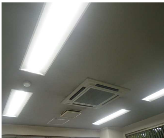
事務所にLED設置
