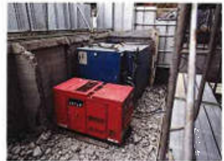
ガラシャワーと発電機
