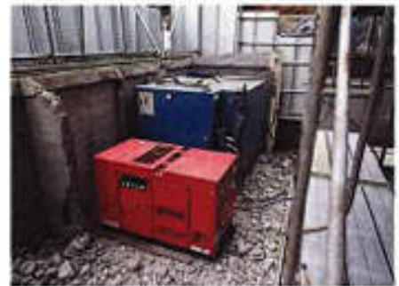
ガラシャワーと発電機
