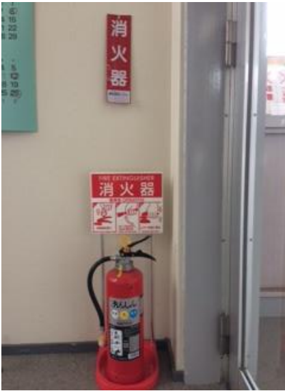
消火器の設置・管理
