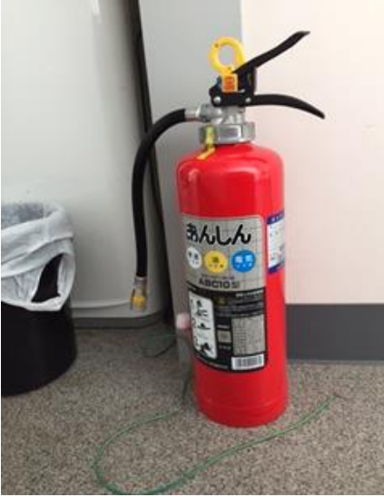
消火器の設置・管理
