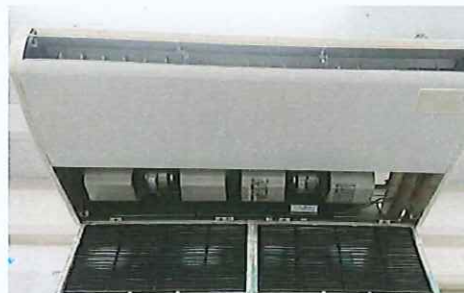
空調機フィルターの定期清掃
