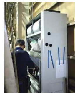
清掃前のファン内部
