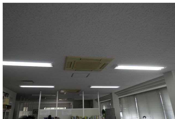
・室内機 交換前
