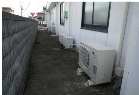
・ 室外機の設置状況
