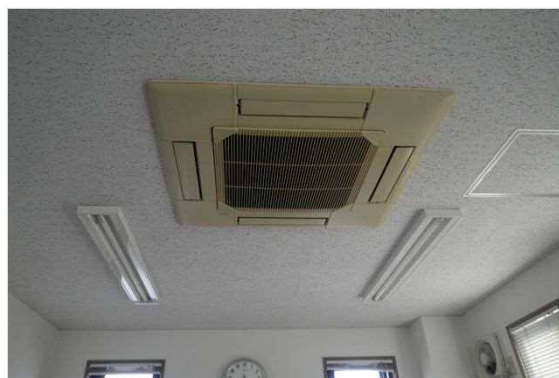
・室内機 交換前
